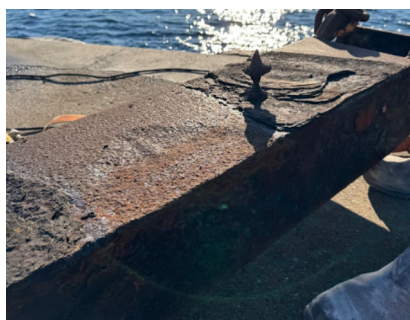
Rostskadade fästen för däck sidoliggande fenderbalk på Hagede brygga. Foto: BGT
