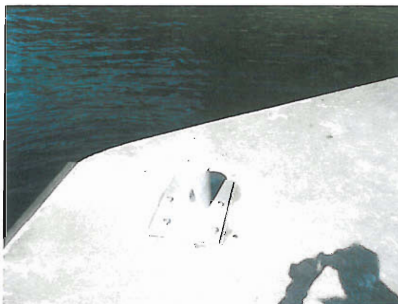
Figur 6. Fukt samlas under fotplattor och kan initiera skador på underliggande betong.
