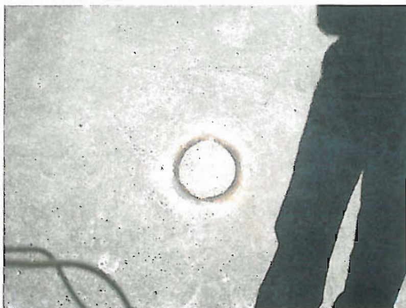
Figur 7. Rör för tidigare pollare har kapats i nivå med betongytan, vilket medfört korrosionsangrepp.
