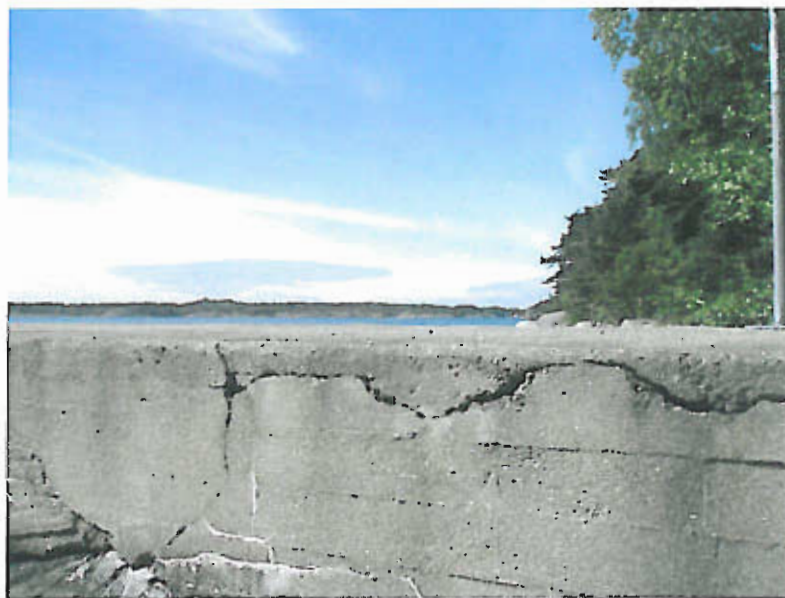
Figur 4. Sprucken betong på övre delen av landfästet.
