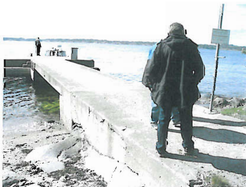
Figur 1. Hasselö brygga. Närmast i bild ses landfästet, därefter ses förbindelseplattan och längst ut den femsidiga plattformen som vilar på ett cirkulärt pelarstöd (ej synligt i bild).
