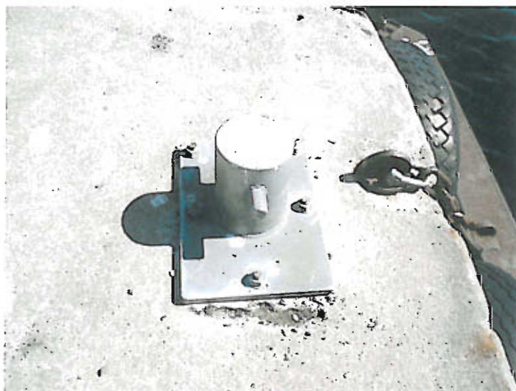
Figur 11. Harö brygga. Skadad betong under pollare. Se även skador på bryggans ytterkant.
