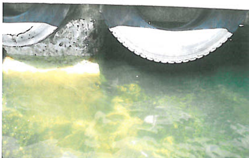
Figur 12. Harö brygga. Skador i vattenlinjen på det yttre skivstödet.
